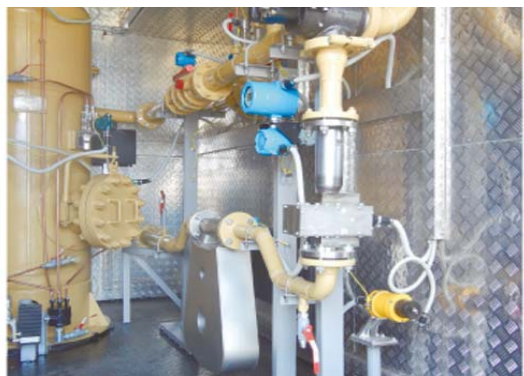
☞ Рис. 2. «ЭлМетро-Фломак» в составе мобильной установки измерения дебита скважин
